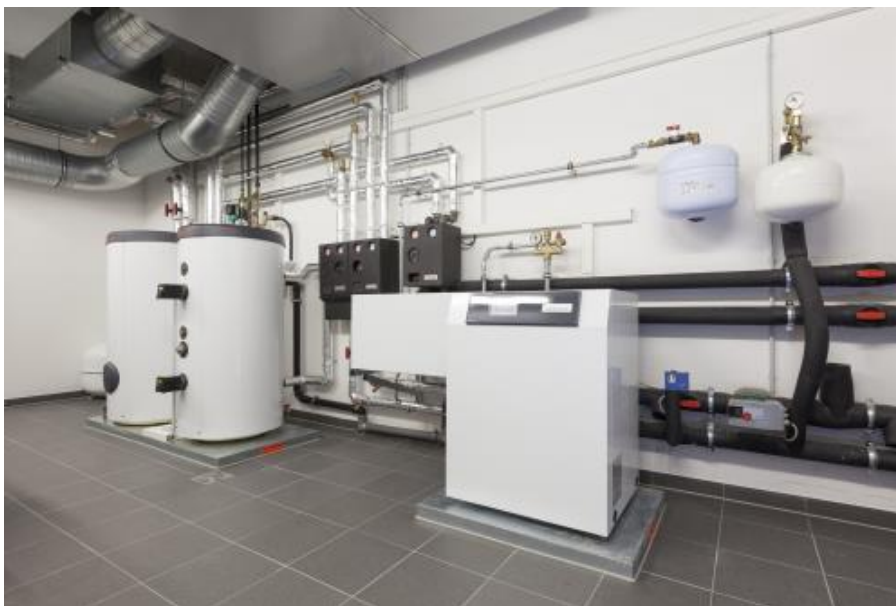
Die Sole/Wasser-Wärmepumpe mit drei Sonden von Weishaupt hat eine Heizleistung vom 10,9 kW. Bildquelle: Fa. Max Weishaupt GmbH
