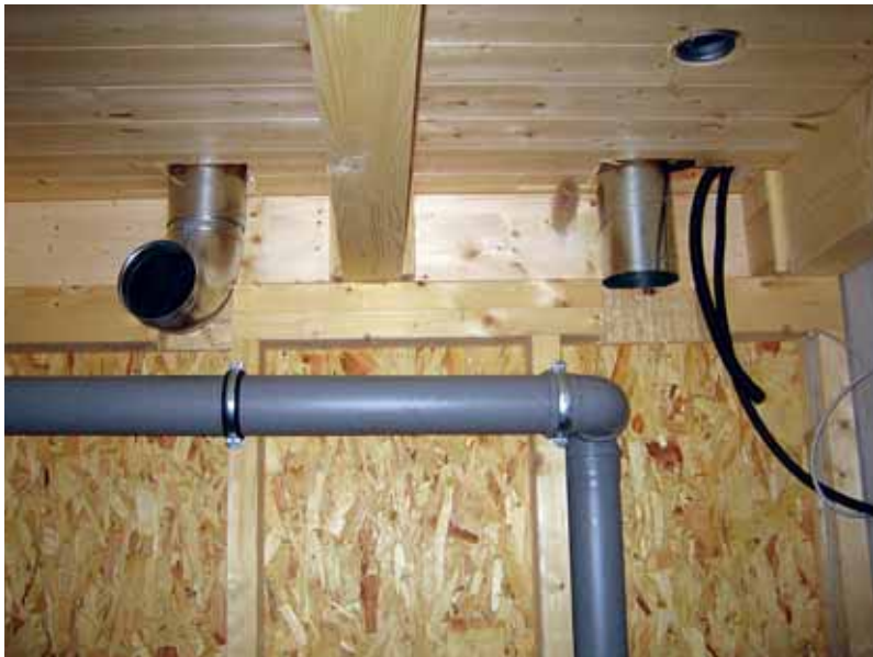
Planung mangelhaft: Bei diesem Einfamilienhaus musste das Lüftungsrohr teuer um das Abwasserrohr herum gelegt werden. Eine Lösung, die auch den Balken schadete
