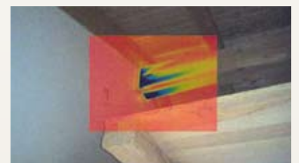
Luftundichtigkeit während der Inspektion mit dem Blower-Door Verfahren, Bild-im-Bild-Darstellung
